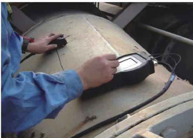
管道腐蚀检测
